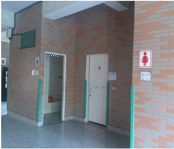
廁所設置-男女廁標示清楚
